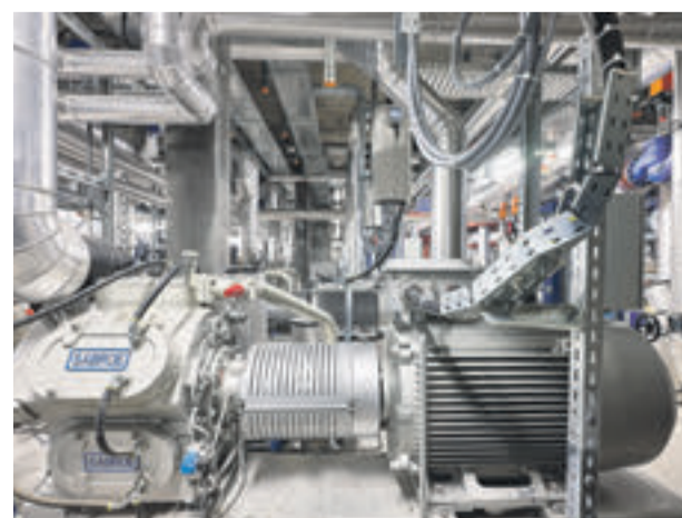
La chaleur dégagée par les machines réfrigérantes est réutilisée pour les bâtiments et l'eau sanitaire.
